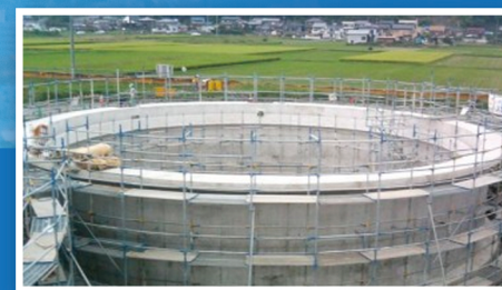
高富浄化センター：岐阜県
